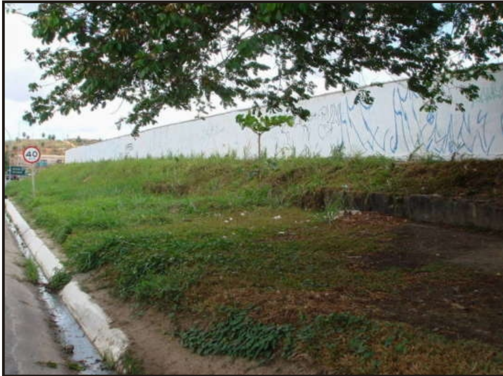
CADASTRO Nº : 012 - COMPESA ( LAGOA DE ESTABILIZAÇÃO ) MURO DE ALVENARIA ENDEREÇO: ROD. PE-060, KM 2, VILA DA COHAB, CABO
